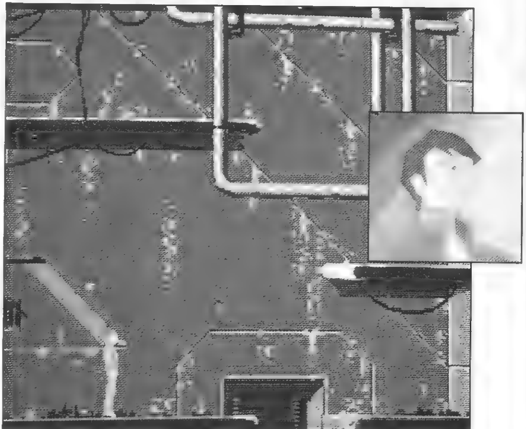
▼ Volles Rohr im Heizungskeller
